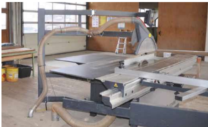
/ Eine außergewöhnliche Absaugung an der Formatsäge: Die Späne werden über den Keller abgeführt, weil lange Bauteile mit einem senkrechten Fallrohr kollidieren.
