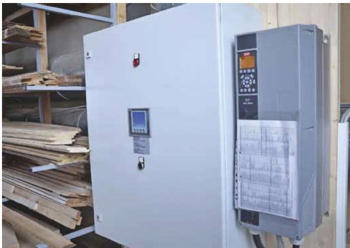
/ Die SPS-Steuerung Simatic S7 1200 und der Frequenzumrichter sorgen dafür, dass nur die tatsächlich benötigte Absaugleistung erzeugt wird.
