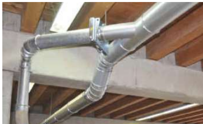
/ Auch in der neuen Absauganlage gibt es die guten alten Schieber – allerdings werden diese elektropneumatisch gesteuert dem benötigten Strömungsbedarf angepasst.
