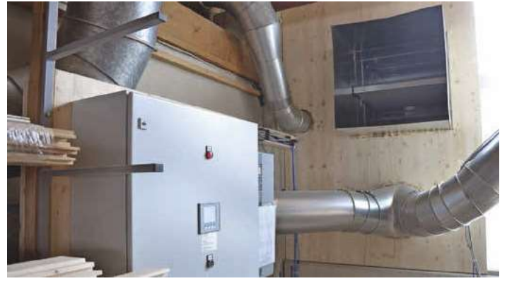
/ Der quadratische Wanddurchbruch markiert die Rückführung der warmen Luft aus dem dem Filterhaus, das direkt hinter der Wand installiert ist.
