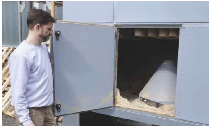
/ Joachim Hillmann und die Tür des Filterhauses geben den Blick auf die Rundaustragung frei, die füllstandsbezogen die Späne in die Zellenradschleuse weitergibt.
