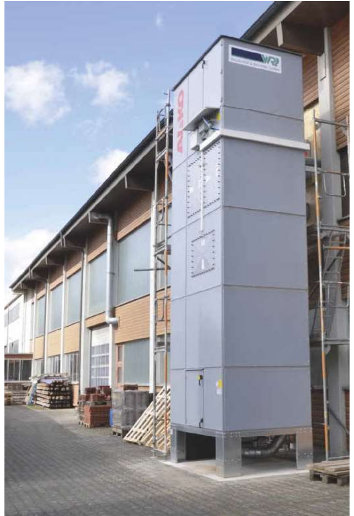
/ Heute steht bei Hillmann Holzbau eine Al-Ko-Systemfilter-Anlage „Profi Jet“ mit einer Leistung von 15 000 m 3 /h, die platzsparend neben der Halle installiert ist.
